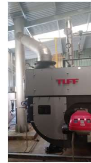
Nồi hơi biogas đã lắp đặt
